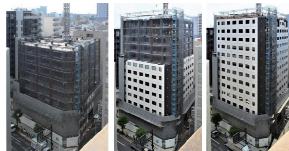
⑫工事の進行の様子 建物の内側から外壁を取り付ける、安全性の高い「無足場工法」を採用
